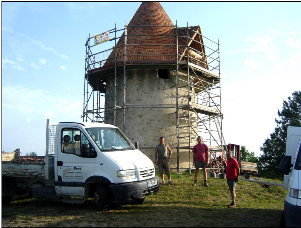
La couverture du toit, magnifique touche finale à l'édifice, est assurée par les ouvriers de Robert Rocq, artisan couvreur à Port-Sainte-Foy
